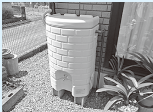
雨水タンク（200Lサイズ）の設置例
