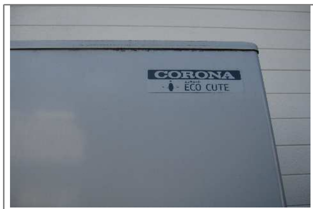
着工前:既存給湯器 メーカー名
