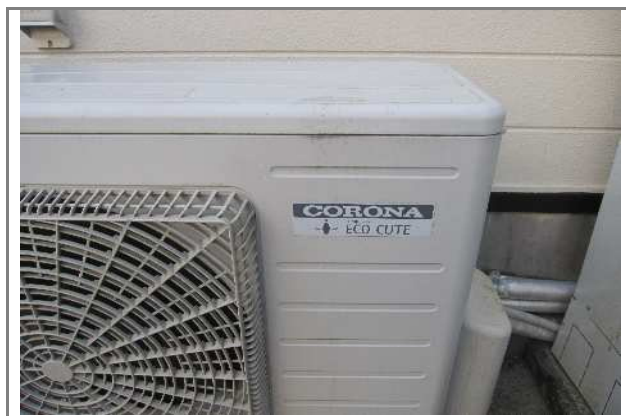
着工前:既存給湯器 メーカー名
