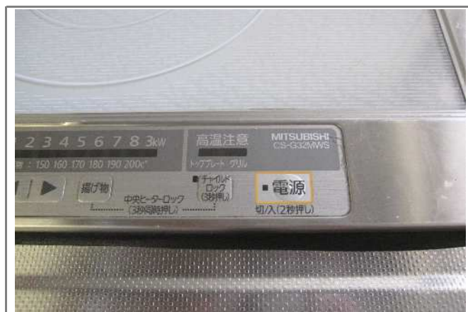
着工前:既存加熱器の品番又はメーカーの写真
