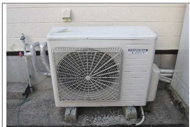
着工前:既存給湯器 メーカー名
