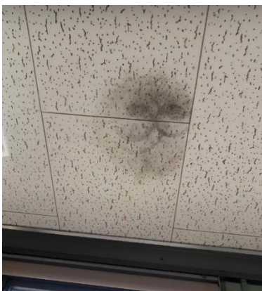
雨漏り（山田谷頭児童館）
