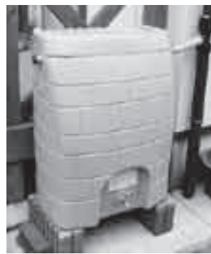
雨どい取り付け型の雨水貯留施設
