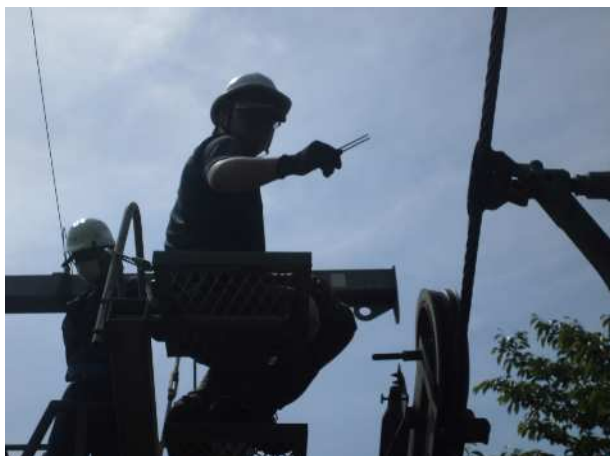
脱索検出装置作動確認
