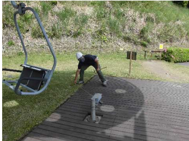
乗越検出装置作動確認
