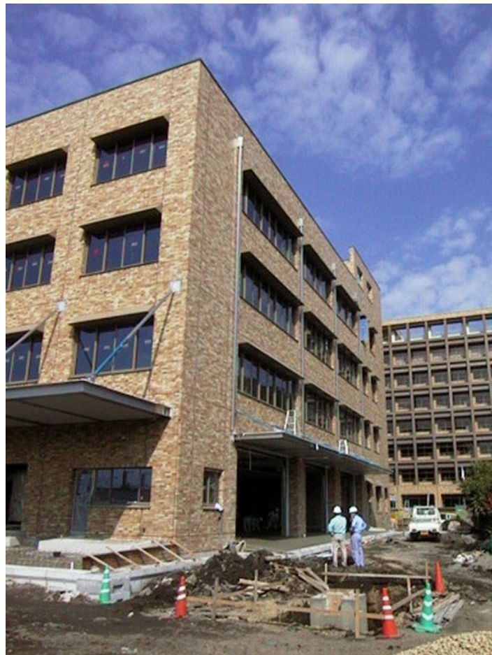
都城市役所南別館に設置した雨水浸透施設
