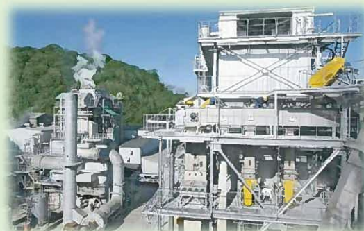
(南国興産(株)の畜ふん発電ボイラー(右)と鶏ふん発電ボイラー(左))
