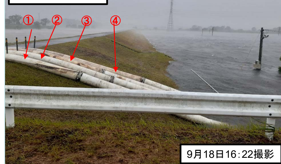
4台のポンプを稼働
