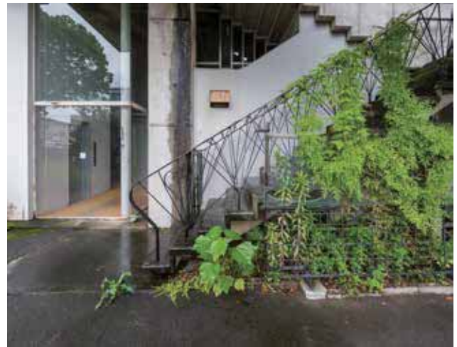
Fig3-3-9. 屋外鋼製手摺
