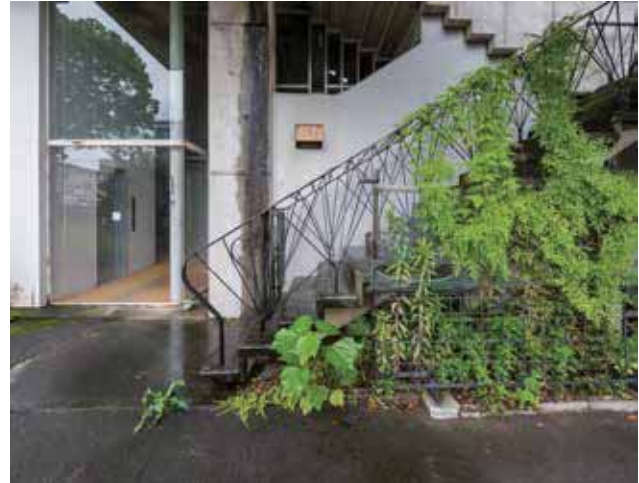
Fig3-5-8. 屋外鋼製手摺
