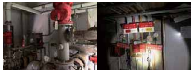
Fig3-2-24. ⑯消化ポンプ1
