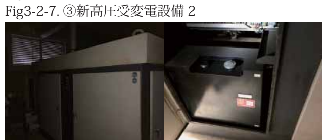
Fig3-2-7. ③新高圧受変電設備 2
