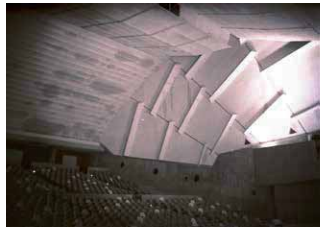
Fig2-4-3.1966年ホール雨漏りの様子 所蔵：都城市
