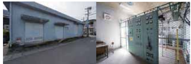
Fig3-2-3. 別棟電気室 (外観) + (内観)
