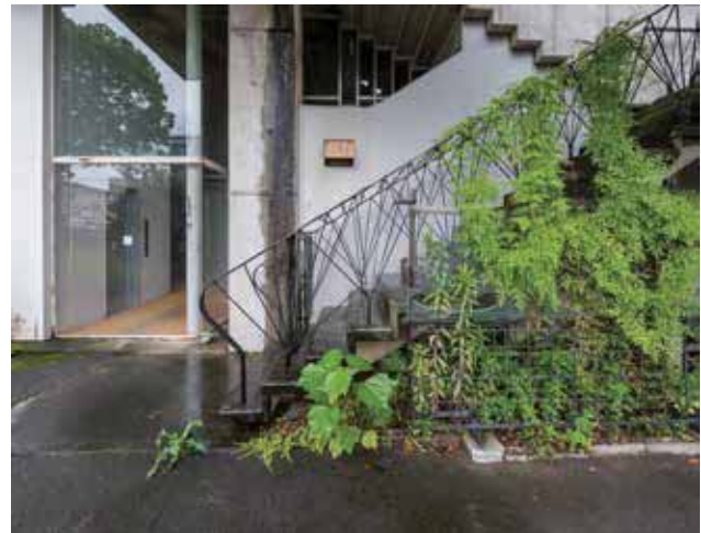
Fig3-5-8. 屋外鋼製手摺
