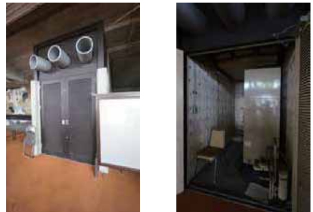
Fig3-2-2. ホールの階段下を改装した空調機械室
