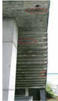
① かぶりAVE 11.7mm 比抵抗AVE 85.4 ② かぶりAVE 8.2mm 比抵抗AVE 96.8
