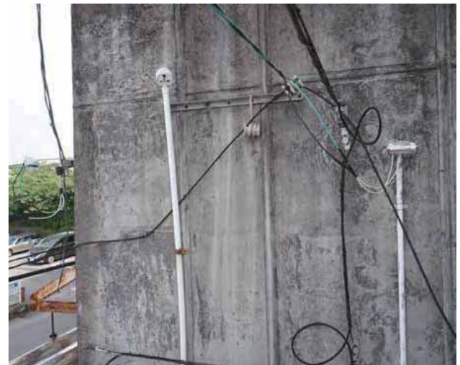
Fig3-2-1. 電気の引込み状況
