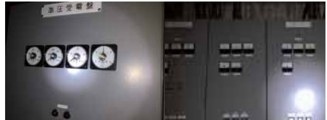
Fig3-2-6. ②新高圧受変電設備 1
