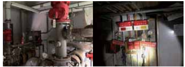
Fig3-2-24. ⑯消化ポンプ 1
