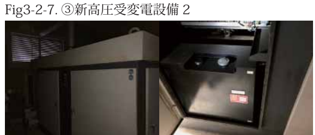
Fig3-2-7. ③新高圧受変電設備 2
