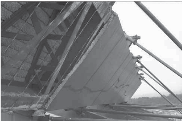
Fig2-4-4.1970年モルタル剥落の様子 所蔵：都城市
