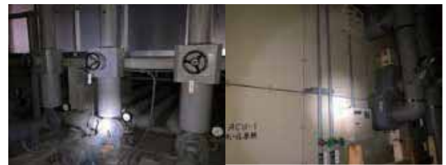
Fig3-2-15. ⑪冷水ポンプ
