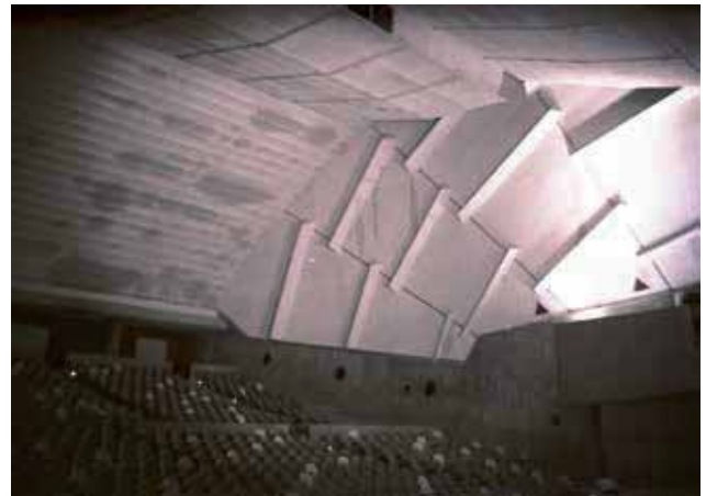
Fig2-4-3.1966年ホール雨漏りの様子 所蔵：都城市
