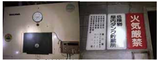
Fig3-2-12. ⑧重油焚きボイラー 1
