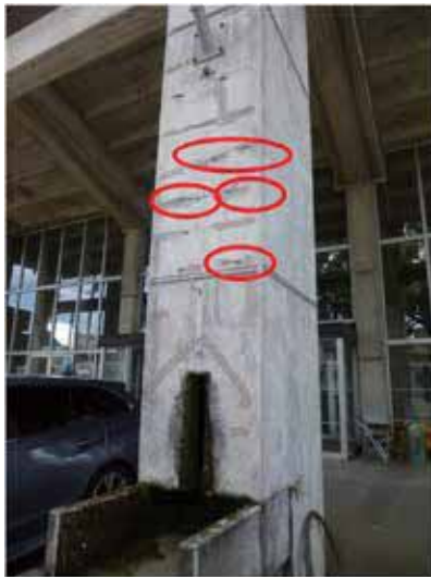
柱 かぶりAVE 6.6mm 中性化AVE 5mm
