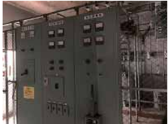
Fig3-2-5. ①旧高圧受変電設備
